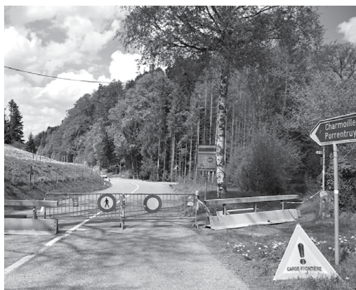
La route en direction de Charmoille a été fermée du 13 mars au 15 juin. Photo gh.
