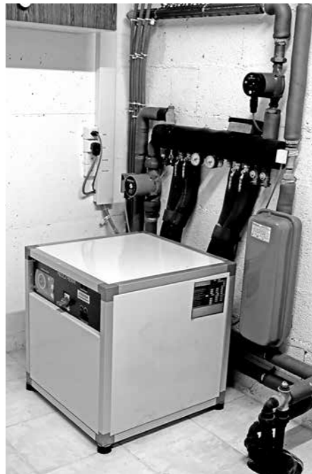
Cette pompe à chaleur de dimensions restreintes (60 x 60 x 60) ne produit pas d'eau chaude. Elle fonctionne depuis 20 ans sans aucune intervention de maintenance ni réparation (28 000 heures de fonctionnement, 1400 par année). Coût: entre 500 francs et 600 francs d'électricité/année pour 200 m². SAE
