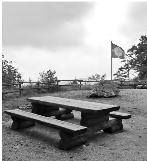
Remplacement des trois anciennes tables ataquées par de la pourriture et réfection de la cheminée à la «Place du régiment 9» à Asuel. Photo lm
